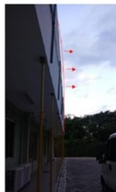
Foto 7: Desaprumo na platibanda.
