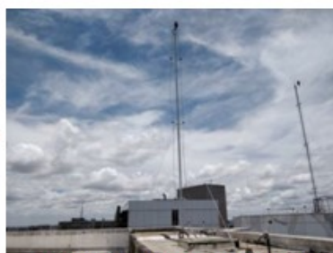
Foto 4: Mastro e pára-raio Franklin.
