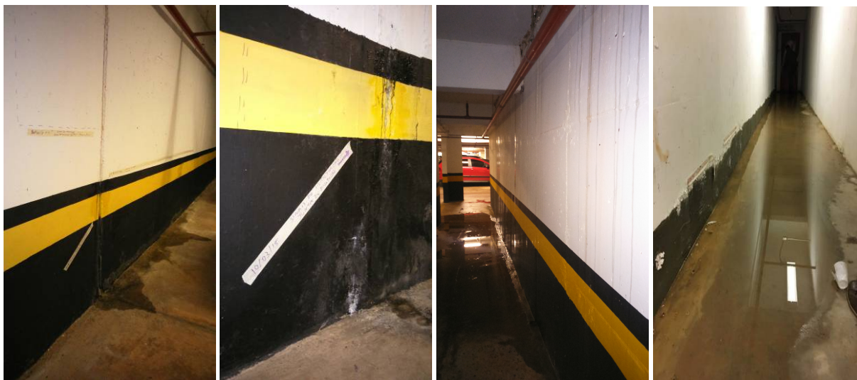
Fotos: Infiltrações nas cortinas de contenção e corredor da saída de emergência dos subsolos de garagens do Ed. Anexo.
